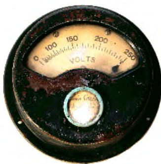
Restes du voltmètre brûlé
